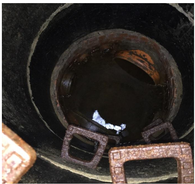
Bild 3: Sammelschacht der Felddrainage
