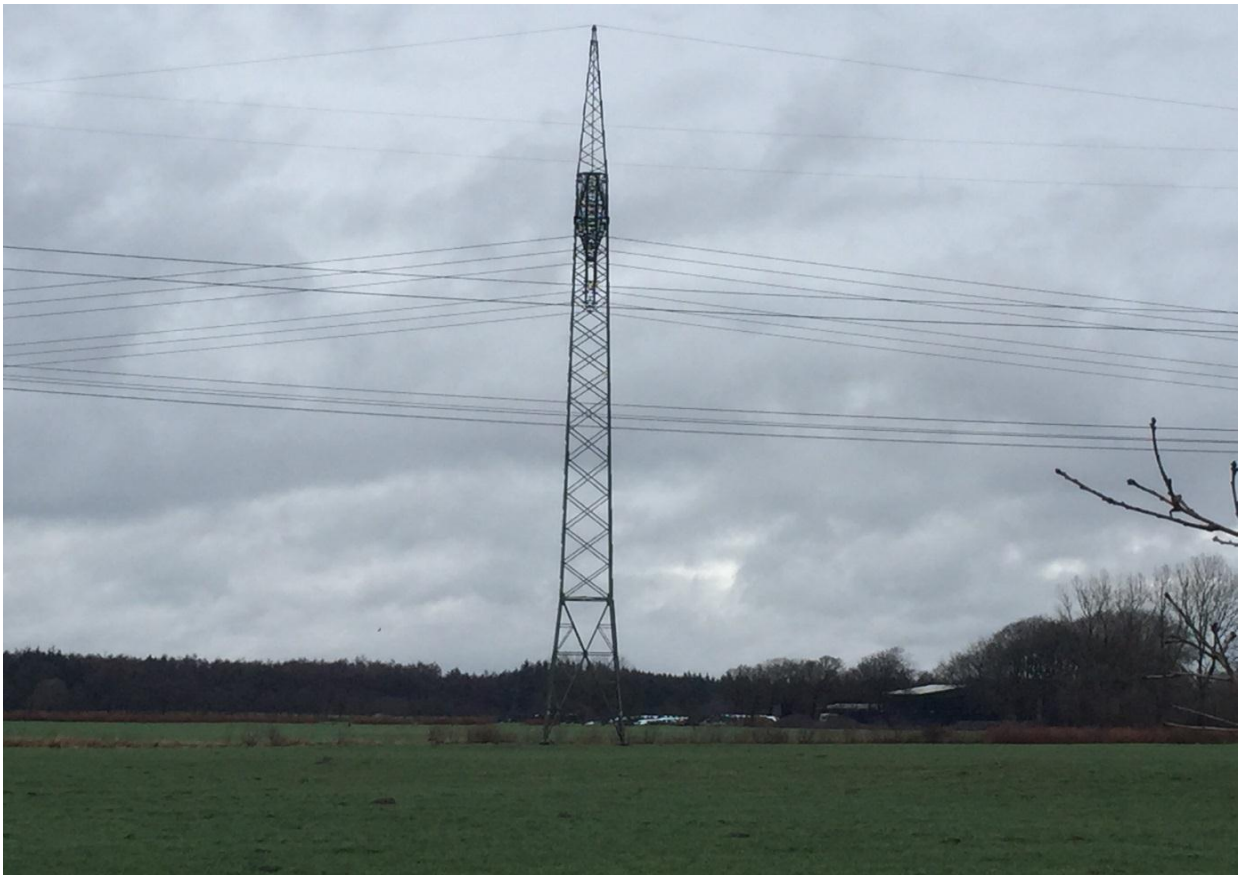
Bild 1: Maststandort 220-kV; Blickrichtung: Nordost
