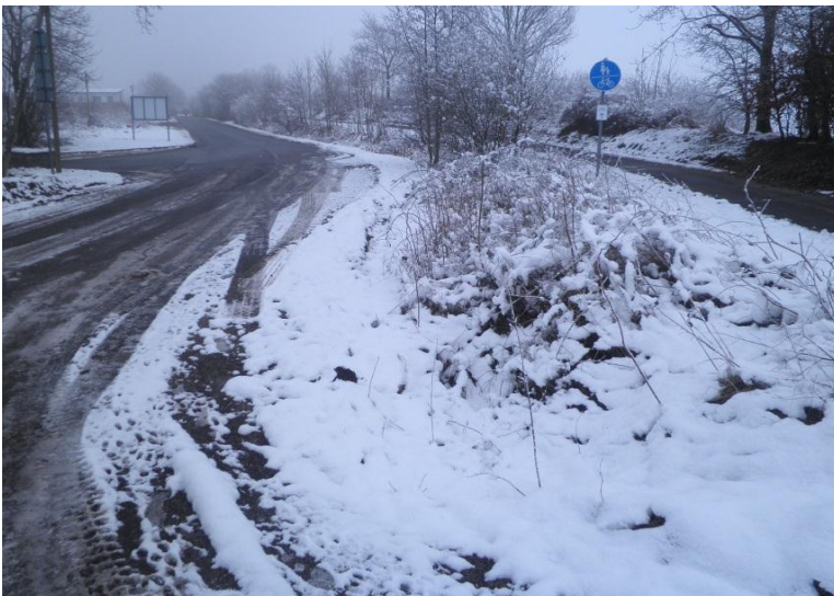
Foto 2: Straßenrandgraben ca. 240 m nördlich (bei Recyclinghof)
