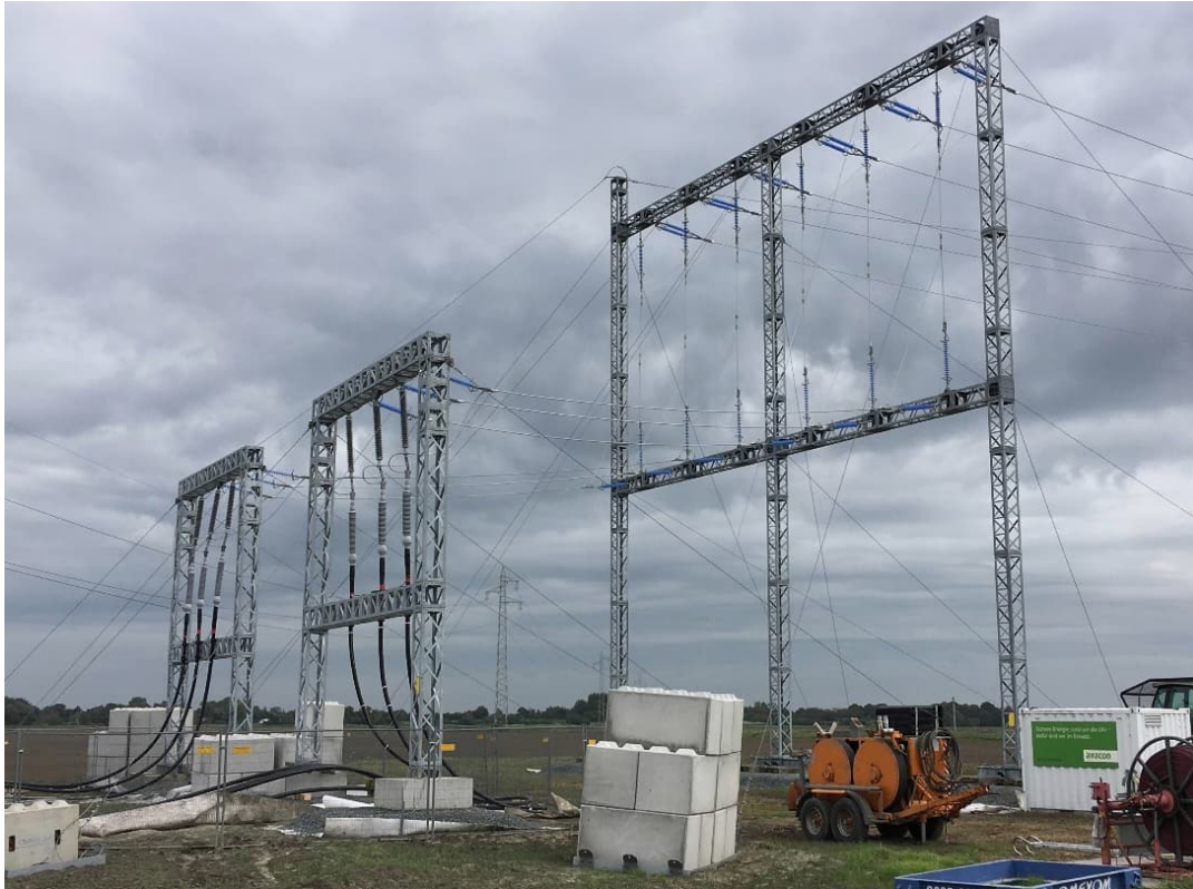
Abbildung 10: 60-kV/110-kV-Freileitungsprovisorium für vier Systeme, inkl. Übergangsanlage Baueinsatzkabel (mit Abankerung und Auflaststeinen)
