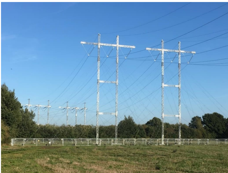
Abbildung 11: 60-kV/110-kV-Freileitungsprovisorium für zwei Systeme (mit Abankerung)
