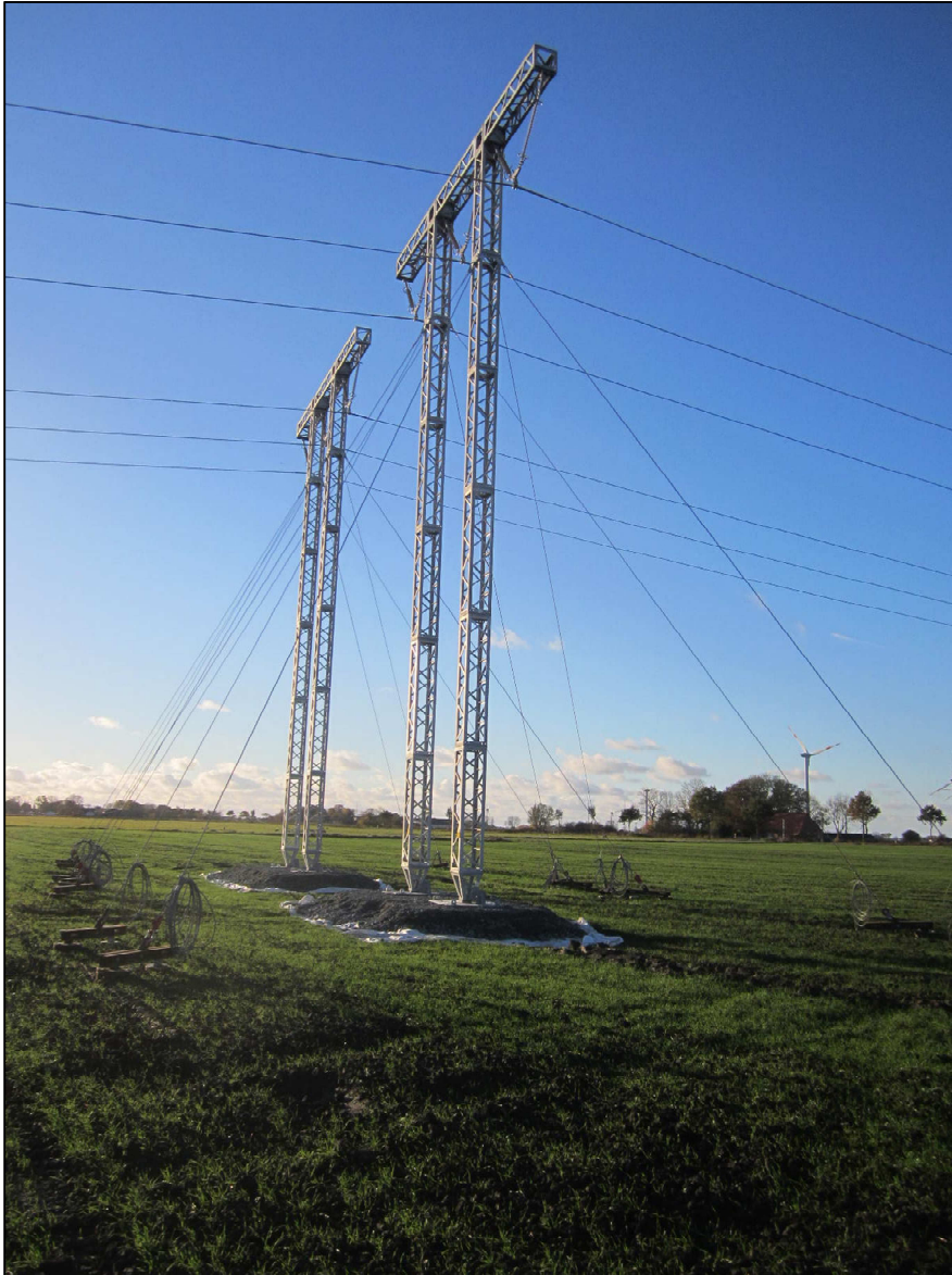
Abb. 6: Beispiel zweisystemiges Freileitungsprovisorium (SH Netz 2017)
