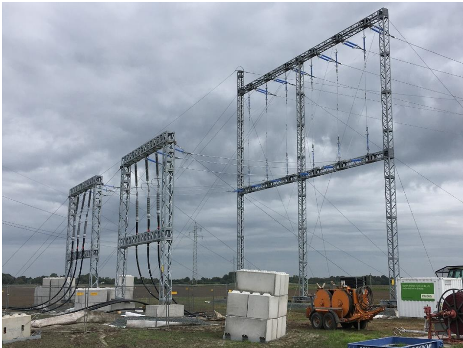
Abbildung 3 110-kV-Freileitungsprovisorium zum Abspannen für zwei Systeme
