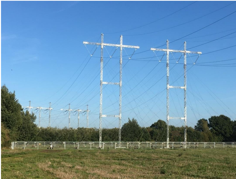
Abbildung 4 110-kV-Freileitungsprovisorium als Träger für zwei Systeme (mit Abankerung)
