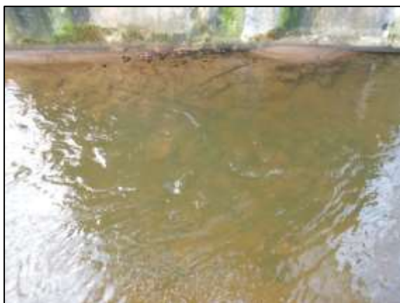
Kolk unter der Brücke
