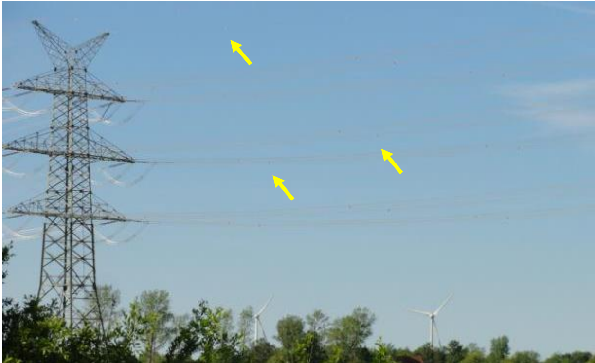
Abbildung 9: Bündelabstandshalter und Vogelschutzmarkierungen an der bestehenden 380-kV-Leitung in Büttel
