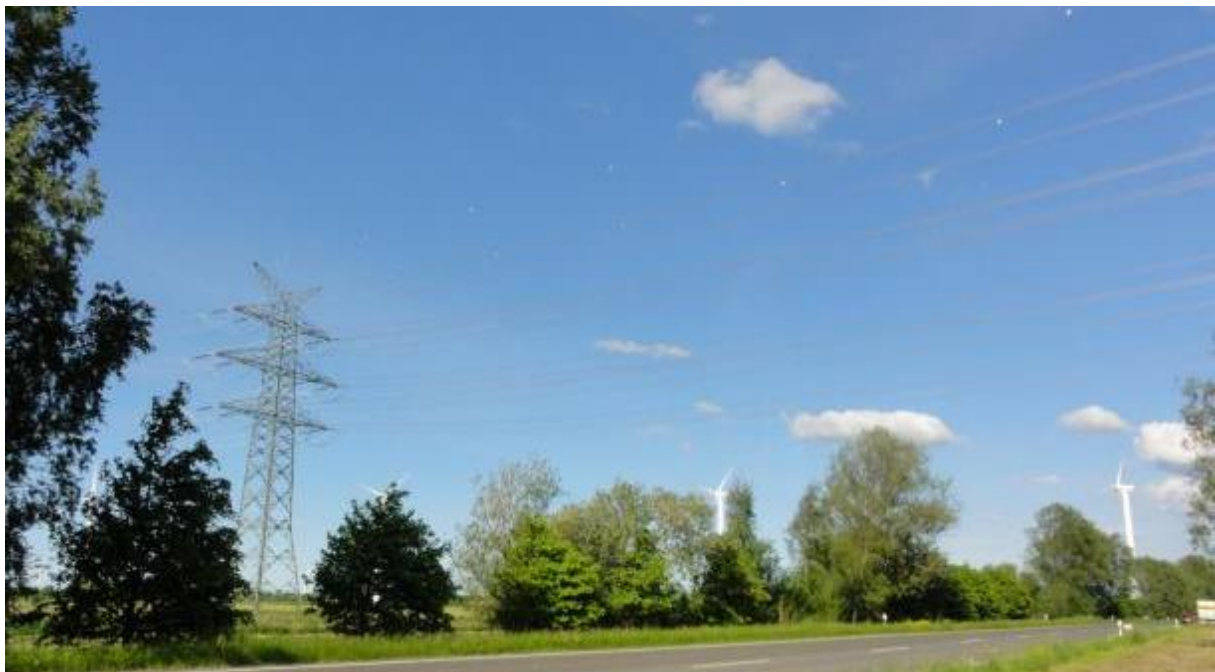
Abbildung 8: Vogelschutzmarkierungen an der bestehenden 380-kV-Leitung in Büttel
