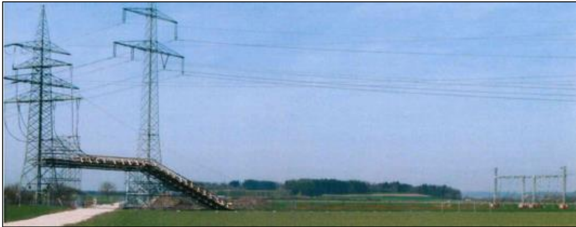
Abbildung 18: Kabelbrücken im Bereich der Provisorien zur Querung von Straßen
